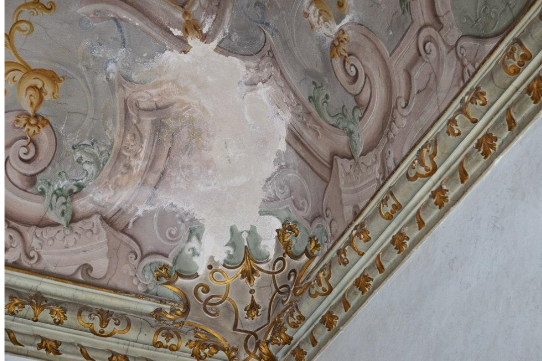
Municipio di Pavia (2016): danni da infiltrazioni dal tetto
